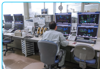
▲広域水道センター中央かんしシステムのようす
