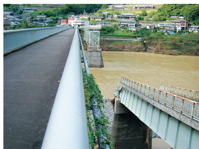
国道168号折立橋のひ害
