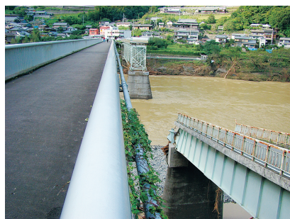
国道168号折立橋のひ害
